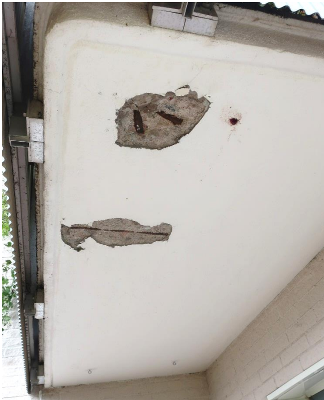
Bild 1. Spjälkningar vid tidigare lagade ytor. Balkong Våning 2 entréstepel Hus 53.
