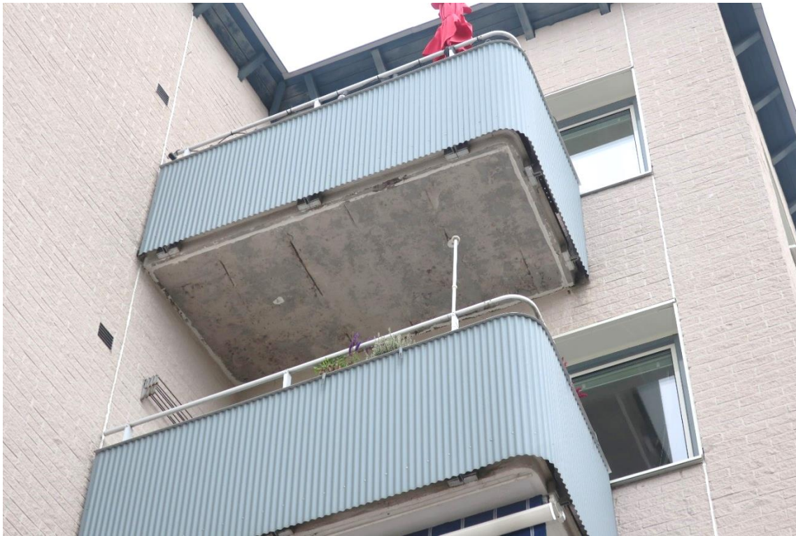
Bild 2. Plattor med synlig underkantsarmering. Balkong våning 4, Hus 57 över entré.
