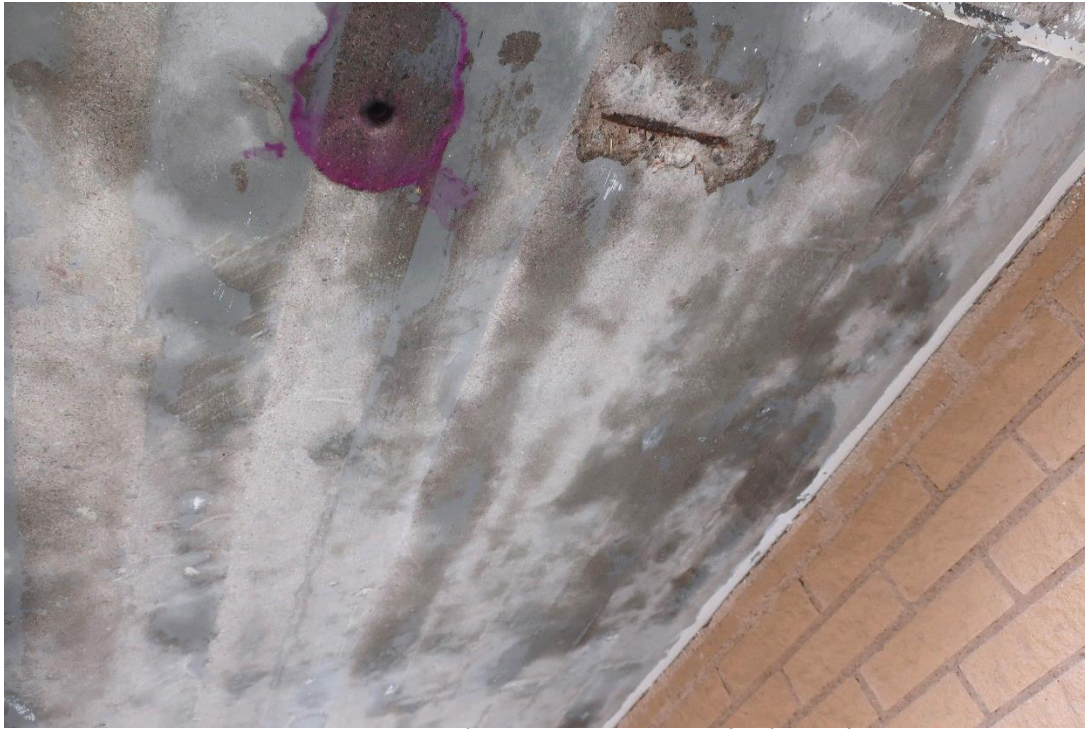
Bild 4. Fuktig undersida, Hus 50 våning 3, generellt på vån.3 låghusen.
