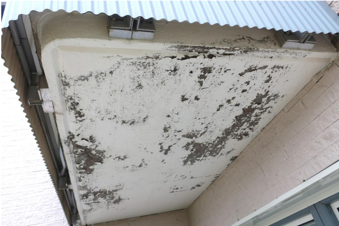
Bild 5. Genomfuktad platta, stapel över entré, Hus 53.
